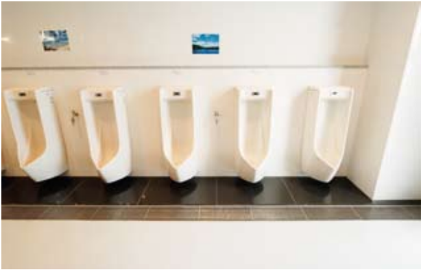
小便器のわきには水栓が設けられている。壁際からグレーチングまでがウェット清掃の範囲。通路部分はドライ清掃方式と区別されている。
