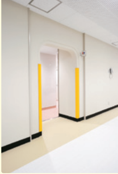
小学部の低学年用トイレの廊下側の入口は、左右の角を黄色の緩衝材でくるんで視認性と安全性に配慮している。
