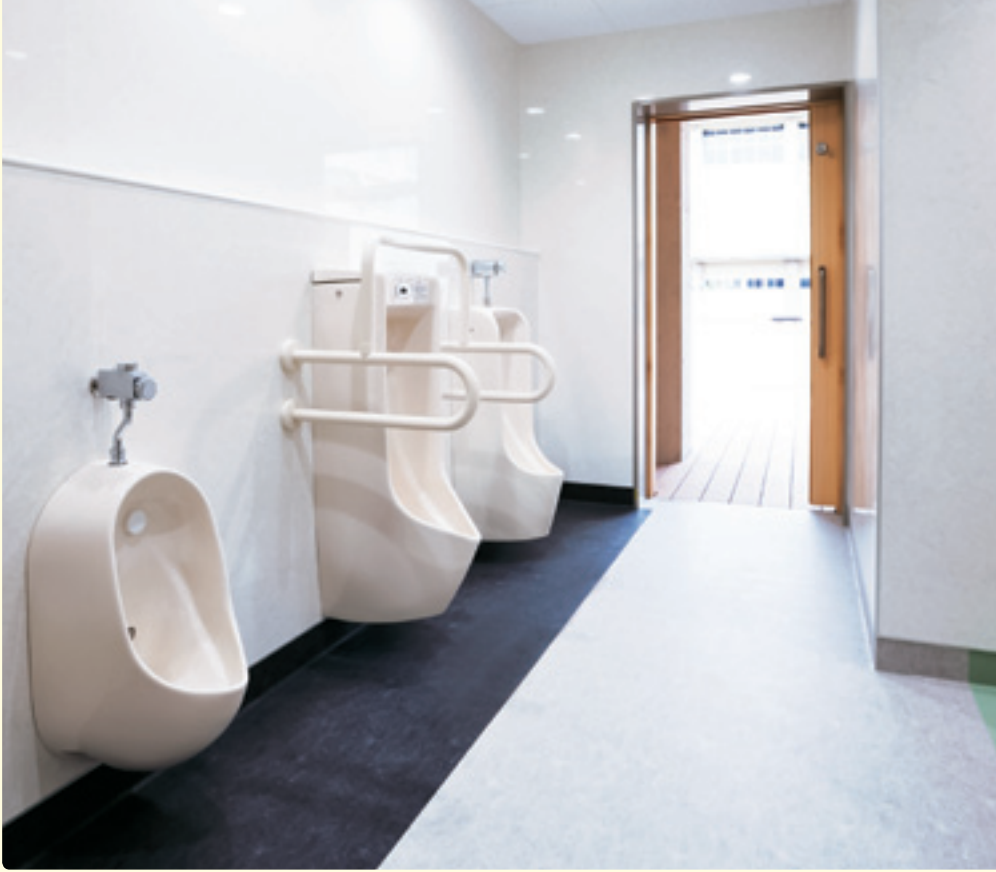
幼児用、自動洗浄などのさまざまな形状の小便器が並ぶ小学部トイレ。壁はメラミン不燃化粧板を使用。
