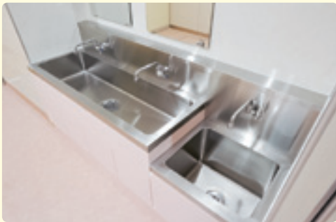
どのトイレにも大きな流しを設置。大切な歯磨き指導や、感染防止の手洗いに使用する。水栓金具もさまざま。
