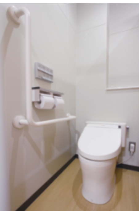
女性職員用トイレの温水洗浄便座。電池交換をしなくていいように、ボタンを押すたびに発電するリモコンを採用。
