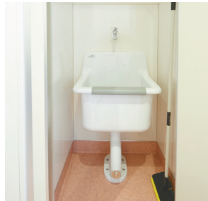
掃除流しは男女共用で省スペース。巾木高まで床材を巻き上げ、清掃性配慮。
