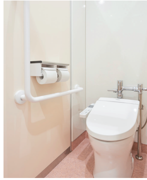
それぞれのトイレの中の個室ブースの一つには手すりを配置。
