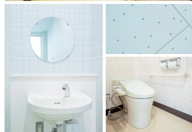
花柄のクロスなどを採用し「自分の部屋」のような落ち着いた雰囲気を演出。L型手すり付きのブースには温水洗浄便座も完備。
