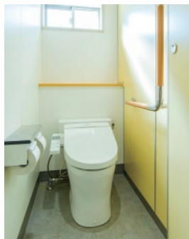
南棟1F東側の女子トイレ。便座は「家と同じ」を基準に、すべて温水洗浄便座に。
