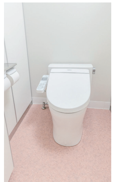
1F女子トイレ内。改修前はトイレに並ぶことが多かったので、連続洗浄が可能なフラッシュタンク式の便器を採用。
