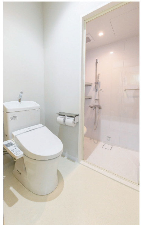
養護教諭からの要望で保健室内にシャワーとトイレを設置。児童が排泄を失敗したときなどに備える。以前、保健室の隣にあったシャワーを保健室内に設置したことで便利に。
