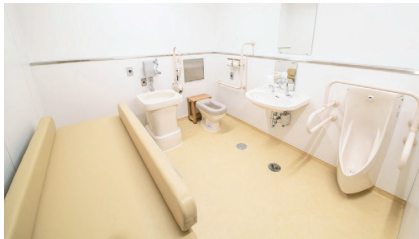
プールサイドの男子トイレ。介助用ベッド、汚物流しなども完備し、さまざまな障がいの児童・生徒に対応できる。
