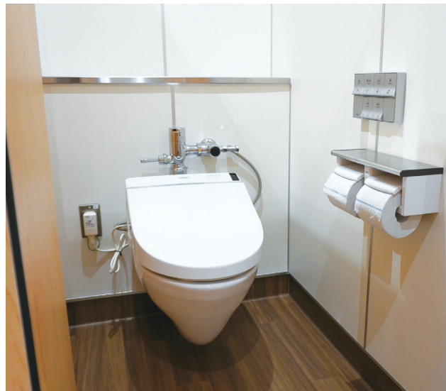
1階女子トイレのブース。全ブースに床の清掃性が高い壁掛大便器と温水洗浄便座を設置。温水洗浄便座は、押すたびに発電する電波式リモコンを採用。男女とも、リモコンには擬音装置機能も備えられている。
