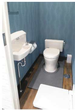
男女共用個室。手洗いを設置 した個室完結型で、着替えのた めのフィッティングボードと大便 器下専用の防汚陶板を設置。
