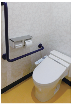
女子トイレ。温水洗浄便座を装 備した他、フィッティングボードも 設置。ブース内の設備は男女ト イレとも共通仕様。
