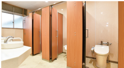
職員女子トイレは温水洗浄便座を設置。中折れ式のドアをはじめ、木目調のブースで温かみのある空間に。
