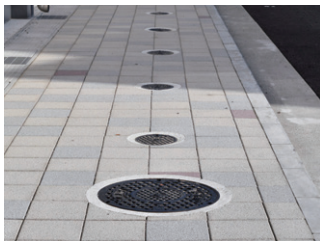
学校敷地内には、災害時に備えてマンホールトイレも設置されている。
