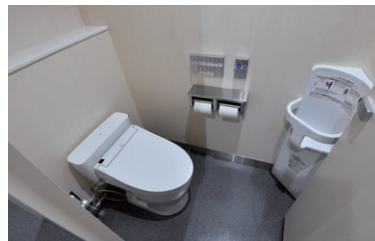
体育館男子トイレ。さまざまな利用を想定し、男子トイレ内にもベビーチェアを配置した。
