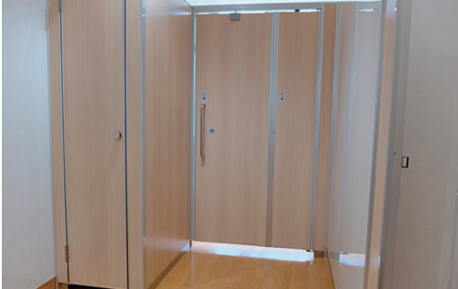
南棟3階東女子トイレ内、広めの個室のドア。トイレの内装は木目調に統一。児童からも「落ち着く」と評判がいい。
