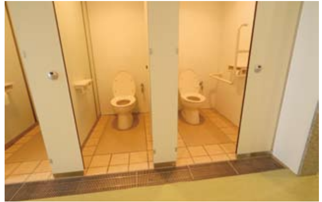
女子トイレに限らずブースの中には水栓が設けられた。
