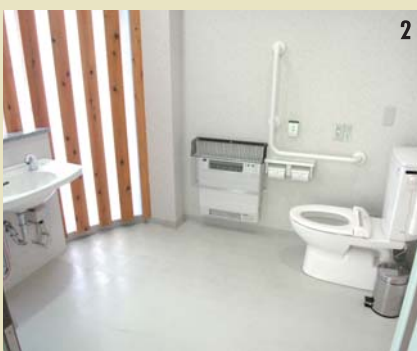
1. 壁面に木を使用し、丸みを持たせたため、丸みのある洗面器と中間色のカウンターで調和をとった。また、スリムなカウンターを使用したため、空間が一層、開放的に。水栓は自動水栓を採用。 2. 入口の円筒部分には多目的トイレが設置された。手すりの勝手が異なるタイプが各階にある。写真は左勝手。
