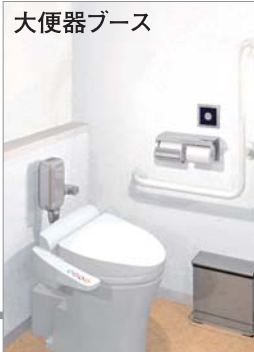
女子トイレのブースには、音姫（擬音装置）を内蔵したシンプル機能のパブリック用ウォシュレットを採用。汚物入れは足踏み開閉式を設置した。
