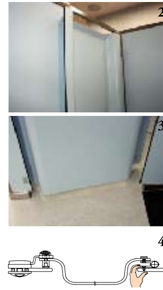
1. 三宿小学校で採用された指詰め防止ドアを備えたブース。ソリッドパネルを使用しているため堅牢性も高い。 2.3. 扉の戸先と吊元部分を曲げ加工し、扉と前面パネルの間に29ミリ程度の隙間を作っており、指をはさまない構造になっている。 4. ドアを上から見ると、仕組みがわかりやすい。隙間はあるが、扉の曲げ角度によりブラインドを作り、中がのぞけないようになっている。
