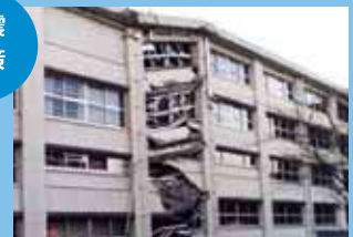
地震による被害状況
