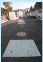
校舎改築にともない、網津小学校も合併処理浄化槽に。マンホールの下に埋設されている。
