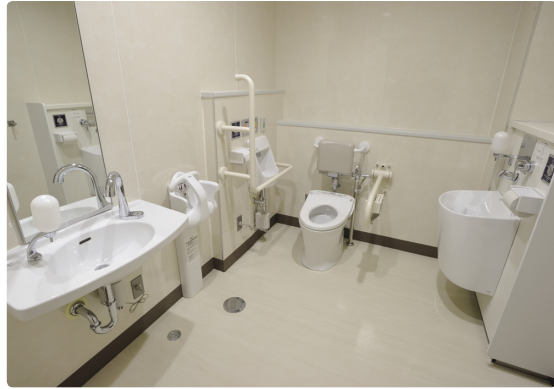
災害避難所として必要なものが揃った体育館の多機能トイレ。体育館男子小便器にも、尿石を抑制し、節水にも効果的なシステムを採用。
