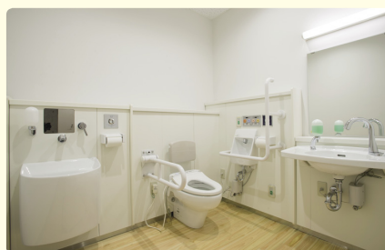
多機能トイレは、すべてオストメイト付き。現状は、学校公開時に高齢者などが利用。
