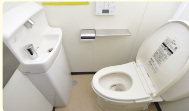
併設された給食センター内の給食従事者専用トイレも、このとき一緒に改修された。コンパクトな手洗器が設置されている。
