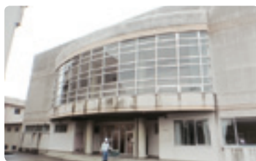
汚れが目立つ改修前。校舎も改修予定だが、天井の落下防止対策のため体育館から着手。
