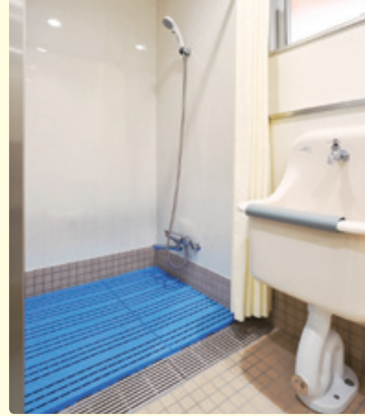
掃除用流しとシャワーは近くにあると、子どもの排せつ指導時に重宝する。壁はトイレと合わせ、浴室用メラミン不燃化粧板。
