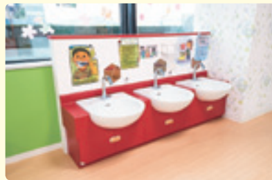
保育室の隅に設置された洗面台も成長に合わせて使いやすい高さに。
