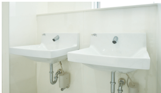
女子トイレの洗面コーナー。水栓の取付面が汚れにくい壁付タイプの自動水栓を採用。
