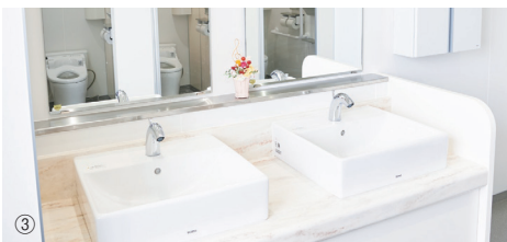
①女子職員用のトイレのブースの空きスペースを利用してフィッティングボードを設置。ストックの履き替えなどに利用されている。②職員用洗面台の自動水栓は、手洗いのあと、自動で除菌成分(次亜塩素酸)を含む水が流れるタイプを採用。排水口のされいが長持ち。③職員用洗面カウンターは2段にして、ハンカチや化粧小物が置けるように。
