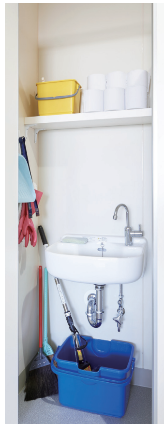
掃除用洗しは、バケツの出し入れがしやすいように浅めのマルチシンクに。水栓は、操作しやすいようレバー式にした。
