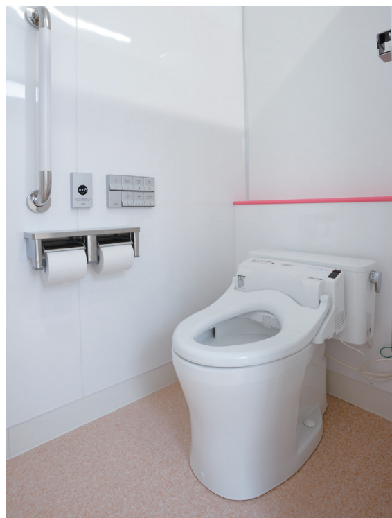
1階女子トイレ。連続洗浄可能なタイプで、次々とトイレが使える。
