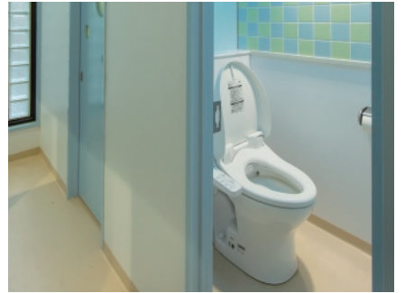
1F女子トイレ。児童が使うトイレの大便器はすべて洋式便器で温水洗浄便座を設置。
