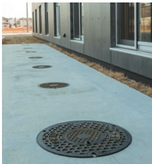
災害時には避難施設となるため、アリーナの裏にはマンホールトイレを設置。
