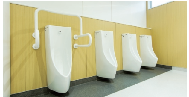
小便器は床の清掃がしやすい壁掛け式。
