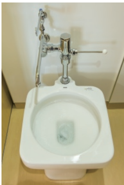
保健室には嘔吐物を処理するための汚物流しを設置。
