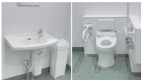
本棟1Fみんなのトイレ。温水洗浄便座はもちろん、洗面器はカウンター一体形で自動水栓を設置。
