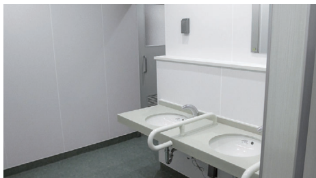
本棟1F女子トイレの洗面コーナー。自動水栓を採用した。奥に見えるドアの先は男女共有の洗面台があるトイレ前室。
