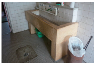
本棟2F女子トイレの洗面台。配管がむき出しで床の傷みも目立ち、常に湿っている印象がある。
