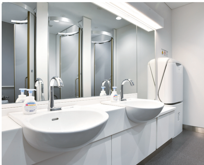
地域用トイレには手洗いのしやすい深さのあるボウルを設置。ベビーシートも設置されている。
