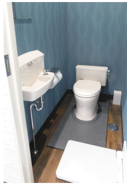
男女共用個室。手洗いを設置 した個室完結型で、着替えのた めのフィッティングボードと大便 器下専用の防汚陶板を設置。
