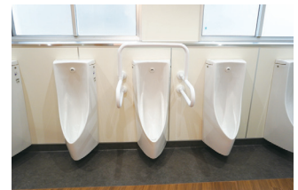
1階男子トイレ。床の清掃性と節水機能に優れた低リップタイプの壁掛自動洗浄小便器を設置。
