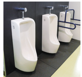
男子トイレ。小便器の床だけでなく、壁面にも汚れや臭いを抑える 陶板を設置。
