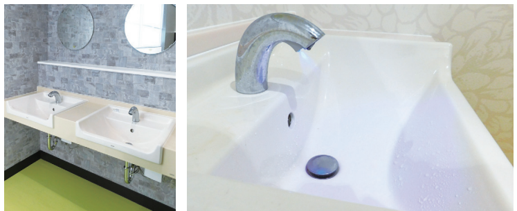
洗面コーナーは自動水栓を採用。使用後に次亜塩素酸を含む水を洗面器の排水口にふきかける 機能つきのタイプで、排水口の汚れを抑制。
