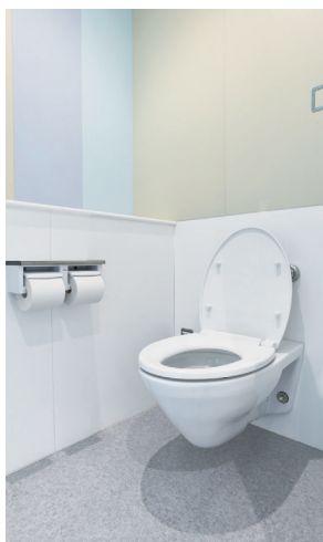
2階女子トイレのブース。壁掛大便器を選定し、掃除のしやすさに配慮。
