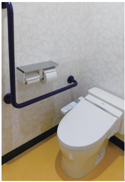
女子トイレ。温水洗浄便座を装 備した他、フィッティングボードも 設置。ブース内の設備は男女ト イレとも共通仕様。
