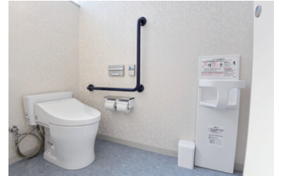
男子トイレ個室。男女別トイレの個室の一つには、ベビーチェアとフィッティングボードも設置。
