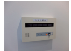
各階のトイレと連動した緊急呼び出し表示器も設置。
