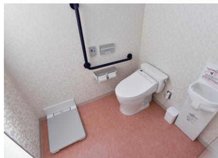
女子トイレ個室。ベビーチェアとフィッティングボードの他、手すりを備えた。大便器はすべて温水洗浄便座。
