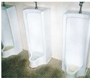
排水管詰まり状態
