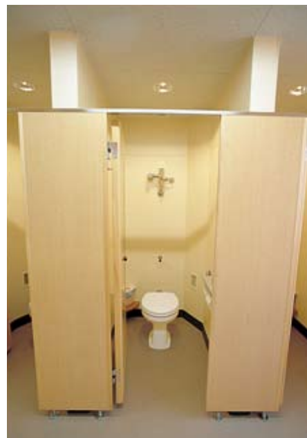
女子トイレ。ブース内換気のため右奥の斜めの壁の内部にダウトが設けられている。
