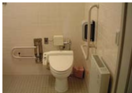
上下 防災棟のオストメイト対応の多目的トイレ。
