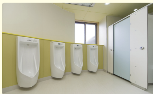
男子用トイレ。小便器は、維持管理がしやすいように自動洗浄式になっている。
