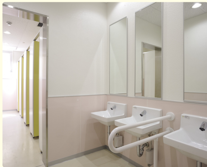
洗面コーナーが混雑しないよう、1,600mmの幅に3連設置できるコンパクトな洗面器を採用。水栓は清掃性のよい壁付きの自動水栓。
