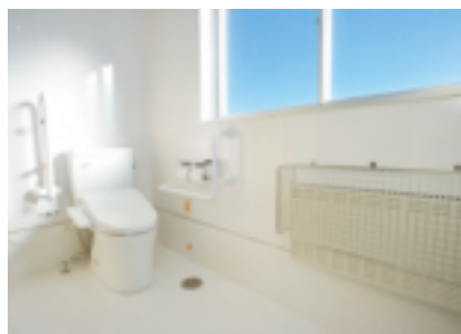
冬季の使用に備えて、サーモスタット式のパネルヒーターを各所に設置。
