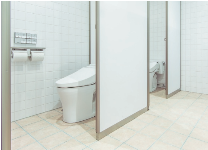
特別教室棟1F女子トイレ。災害時の避難所近くとなるため、すべて温水洗浄便座を採用。
