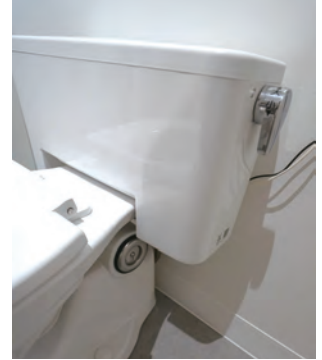
3階北女子トイレ。便器は掃除口が設けられたタイプを採用。
