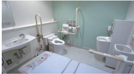
体育館に設置されているバリアフリートイレ。災害時や地域開放時などのさまざまな利用を想定し、オストメイト対応設備やベビーチェアその他、折りたたみ式の大型ベッドも設置。
