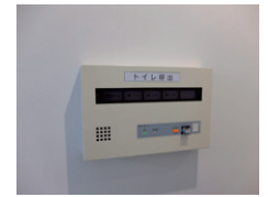
各階のトイレと連動した緊急呼び出し表示器も設置。
