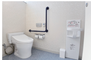
男子トイレ個室。男女別トイレの個室の一つには、ベビーチェアとフィッティングボードも設置。
