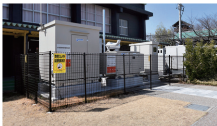
非常用発電機。停電時も、3日分の電気が供給できるようになっている。
