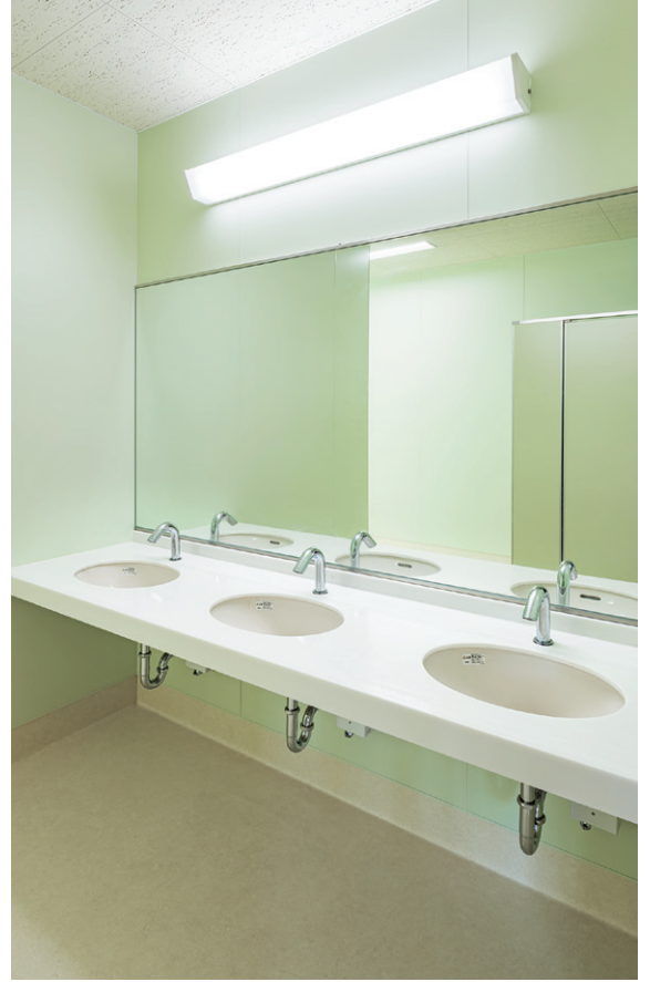
男女トイレの洗面コーナー 非接触の自動水栓に切り替え、照明はLEDに変更され、明るく清潔になった。
