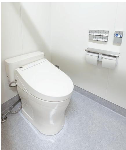
武道館のトイレに設置された温水洗浄便座と発電タイプの電波式リモコン。
