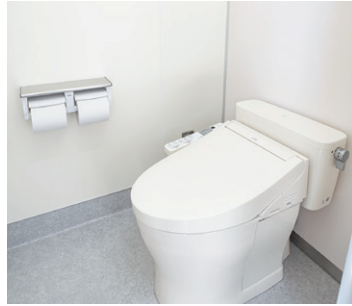
大便器ブース内 洋式化とあわせて温水洗浄便座が標準装備された。
